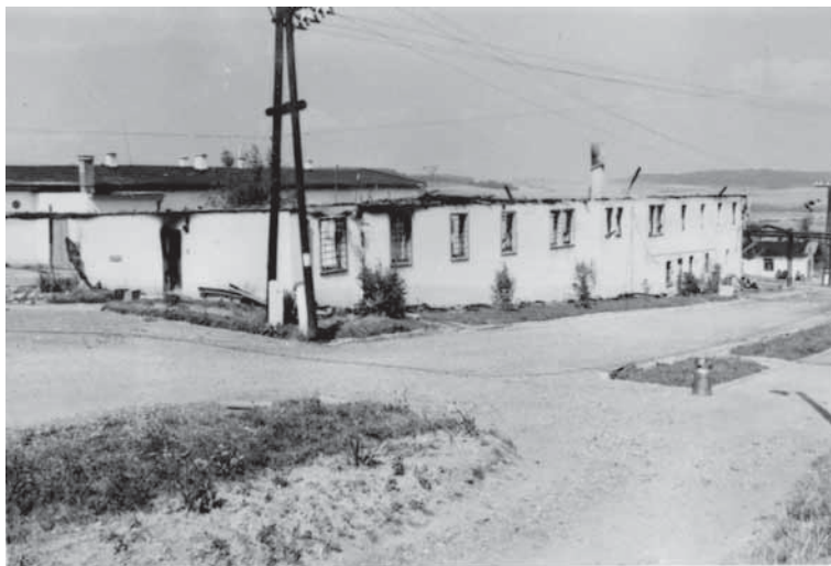
6/ Pohled na škeřelou budovu výchovy v NVÚ-MV Příbram /viz pláněk bed č.8 /
