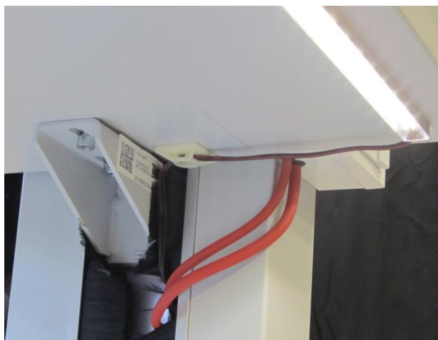
Obr. 3-8 – Umístění LED svítidla na pracovišti
