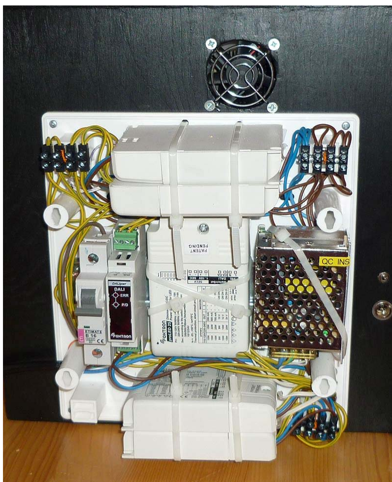
Obr. 4.8 Rozvaděčová skříňka na levé straně modelu
