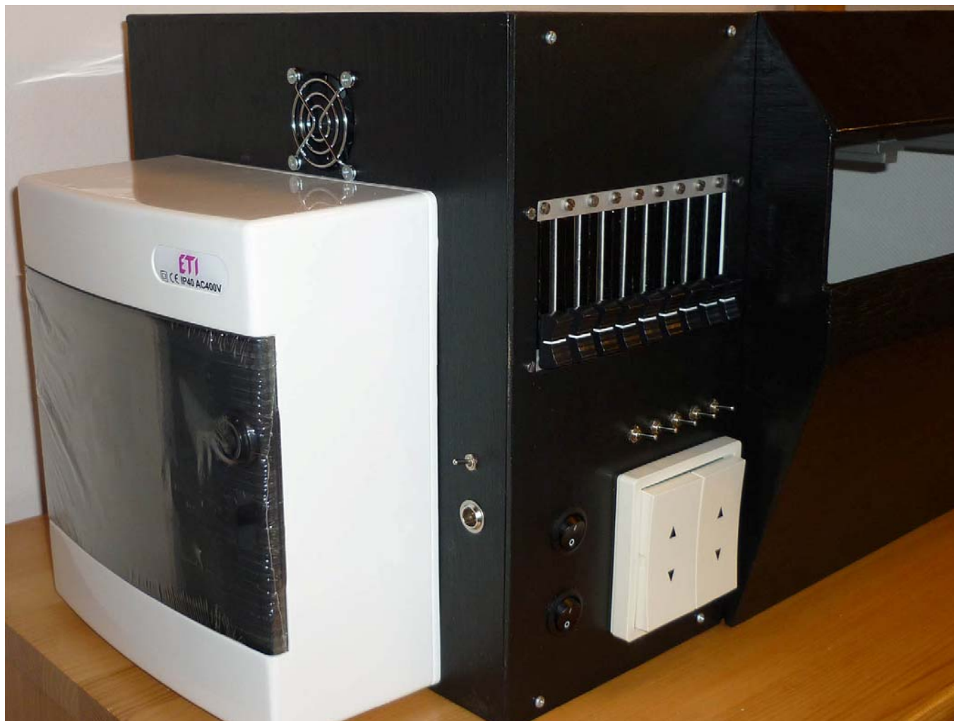
Příloha č. 4: Pohled na rozvaděčovou skříňku a ovládací panel
